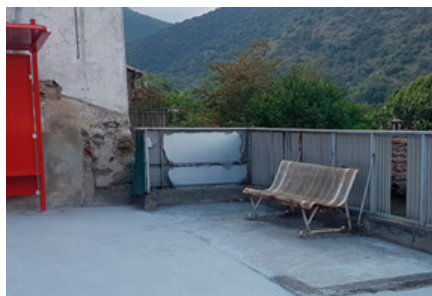
Garde-corps et banc avant aménagement
