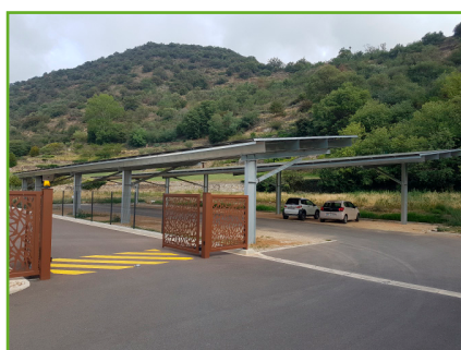
Ombrières sur le parking de la mairie
